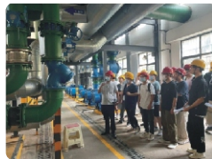
学生在制冷机房认识实习
